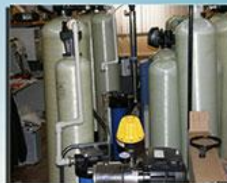
участок автоматических засыпных фильтров
